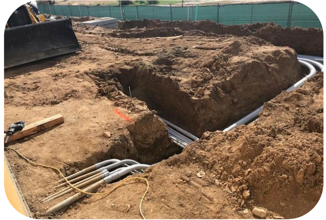
Electrical and Comm. Conduits
